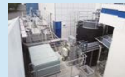
排水処理設備による適切な排水
